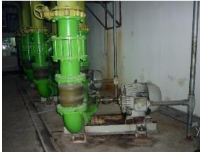
ภาพที่ 3 Condenser Water Pump
