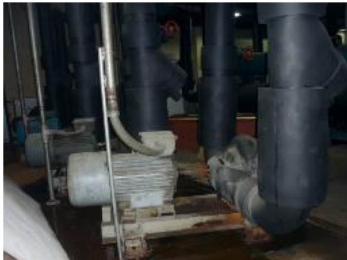
ภาพที่ 2 Chilled Water Pump
