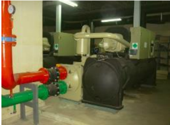
ภาพที่ 1 เครื่องทำน้ำเย็น ขนาด 390 TR
